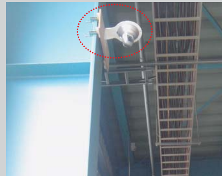
▲ 工場内に設置されたカメラ
