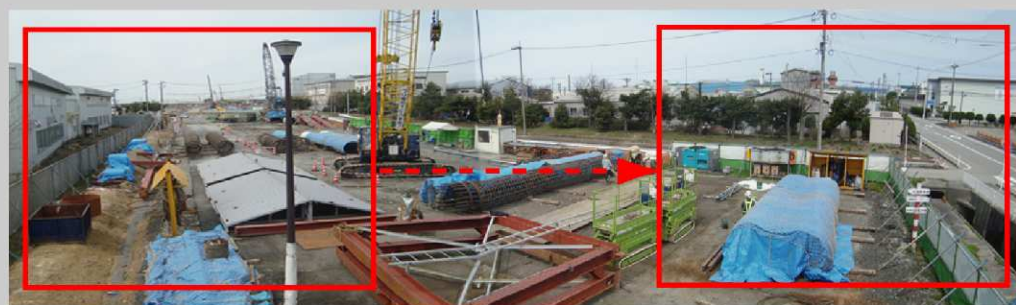
高速パン・チルト機能で、工事現場の端から端へカメラを移動させることができます。
