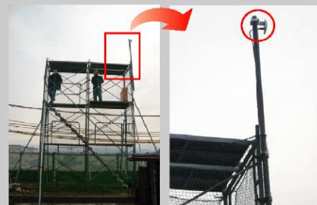
現場の足場に無線LAN機器を設置。
