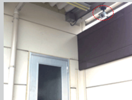
▲ 出入口を監視
