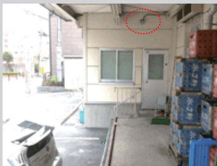
▲ 商品搬入口にカメラを設置
